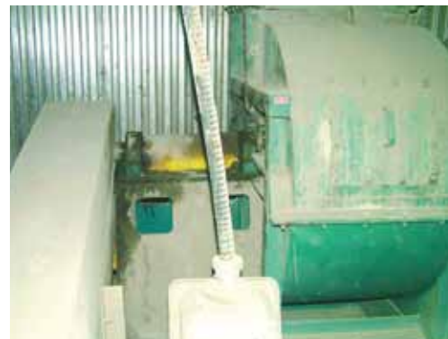
Ventilador del Recolector de Polvo #1.
